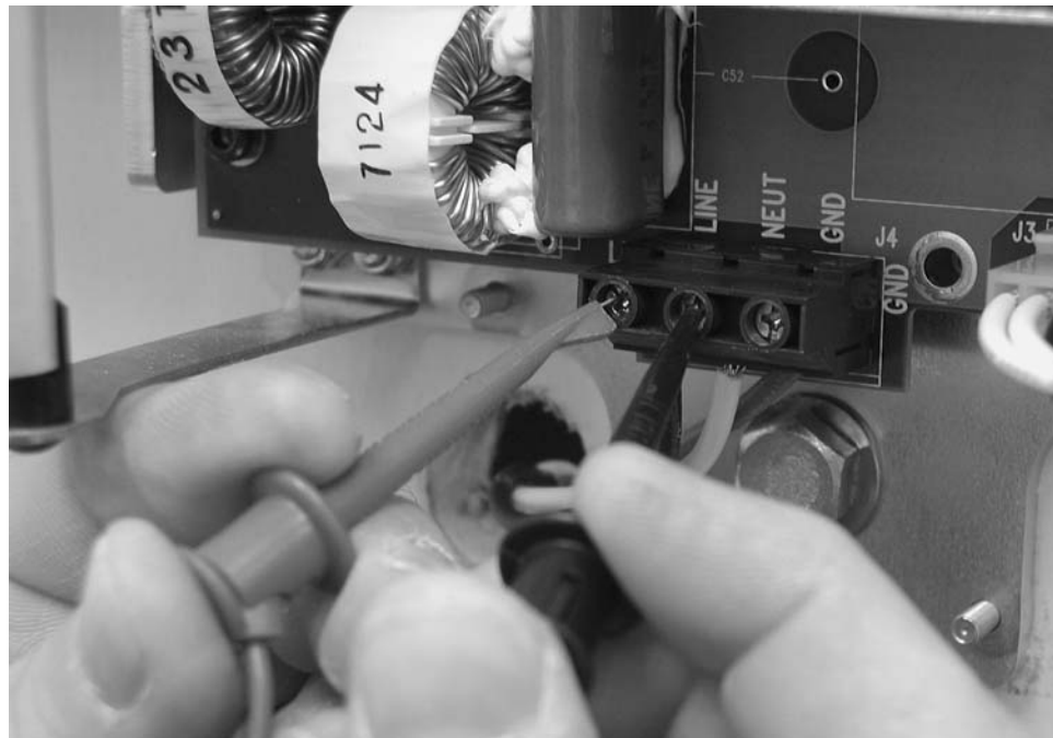
Рисунок 23 Проверка входящего напряжения и на линейном входе
